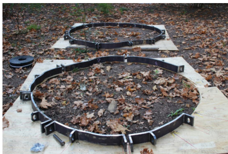
Predisposizione delle flange di coronamento della base del tronco (posta a circa 6 m dal terreno). Ciascuna flangia è suddivisa in spezzoni uniti mediante bulloni per consentire l'allargamento dell'anello nella progressiva crescita della pianta. Ciascuno spezzone è stato convenientemente modellato seguendo le forme della sezione del tronco a livello di applicazione della flangia
