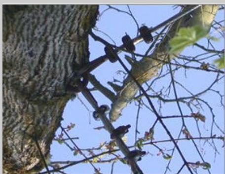
Ancoraggio invasivo con cavo in acciaio
