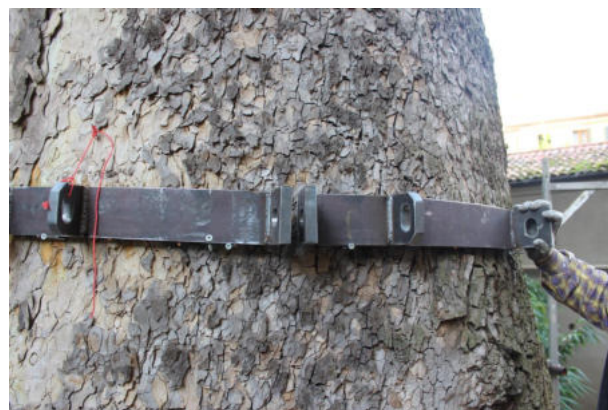
Posizionamento provvisorio di una flangia per la preparazione dei segmenti delle protezioni in neoprene, necessarie per evitare il contatto diretto di profili metallici con la superficie del tronco
