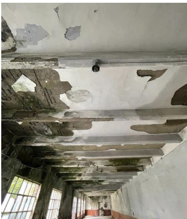
Fig. 4 - Genova. Magazzini della Caserma Gavoglio, ala Est, degrado del solaio in calcestruzzo armato realizzato con il sistema Hennebique.
