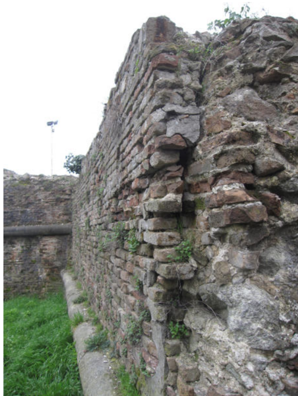
Fig. 4 - Tratto di cortina muraria presso il bastione Castelnuovo con evidente distacco della camicia muraria di rifodera
