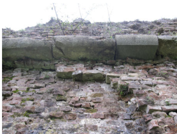
Fig. 3 - Particolare di un tratto di bastione con parziale perdita della camicia esterna. Sono evidenti i bordi della camicia superstite rispetto al crollo, in condizione precaria di stabilità
